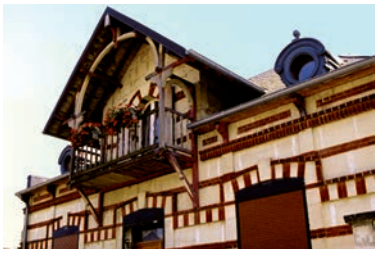
Lucarne centrale avec débord de toiture, boiseries peintes, balcon, lucarne ciel de bœuf
