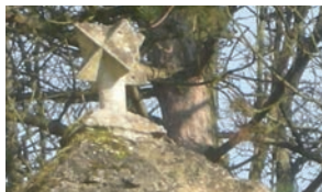
Pinnacle en pierre au dessus d'un puits
